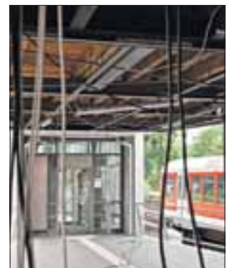
Der Aufzug an der Station Ohlsdorf ist in Betrieb.
